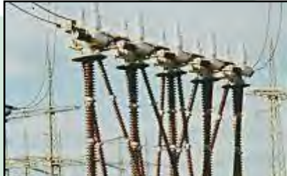
420 kV Air blast CB
