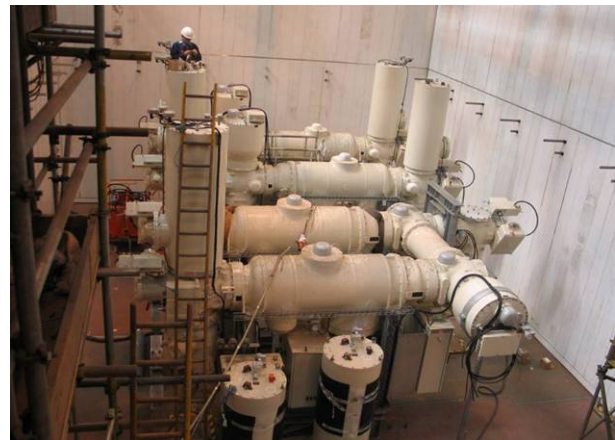
Fig. 10. 33 kV/132 kV switchgear
