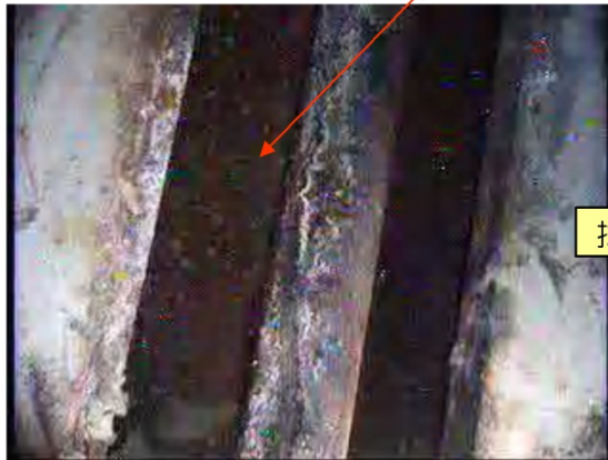
レール溝 拭き取り前
