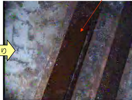
レール溝 拭き取り後
