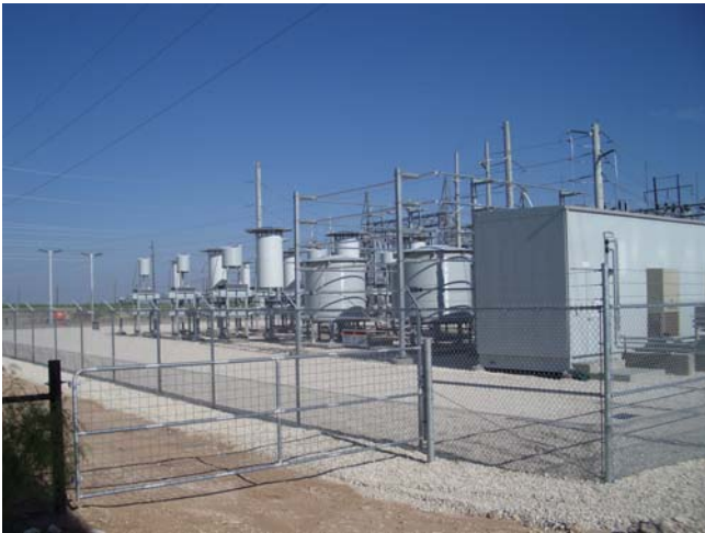
Fig. 19. 69 kV, -40/+50 Mvar SVC.
