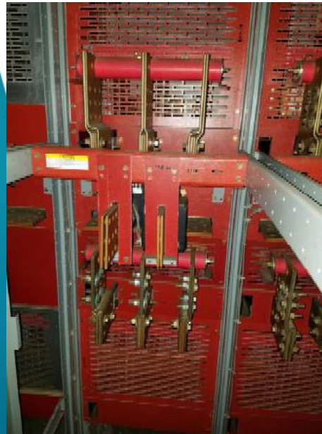
600V Drawout Switchgear
