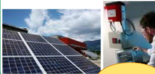
Plate-forme "systèmes électriques"
