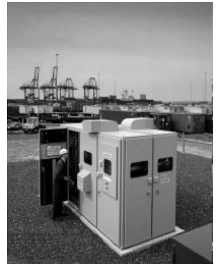
Figure 4 : Réalisée en collaboration, cette installation d'un CAPR fait épargner grosso modo 220 000 $US annuellement en frais de consommation et de facteur de puissance au terminal maritime Seagirt à Baltimore et libère, par la même occasion, de la capacité de distribution pour son fournisseur, la Baltimore Gas & Electric. (On aperçoit sur la photo l'ingénieur de projet Ed Wilson qui œuvre chez Constellation Energy Source, une division « Énergie en prime » de la BGE).
