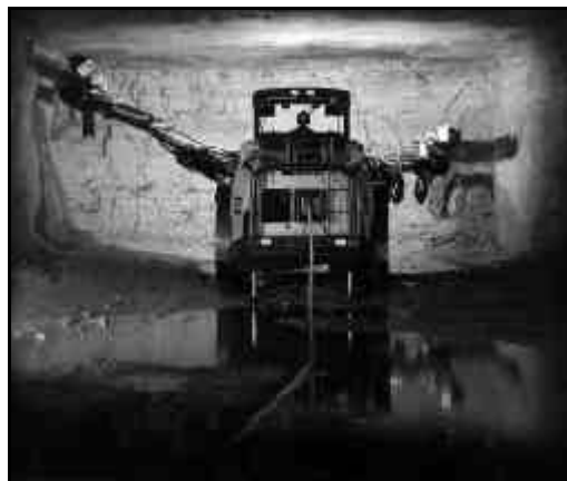
Figure 1 : foreuse à flèche effectuant un forage souterrain (photographie reproduite avec la permission d'Atlas Copco).
